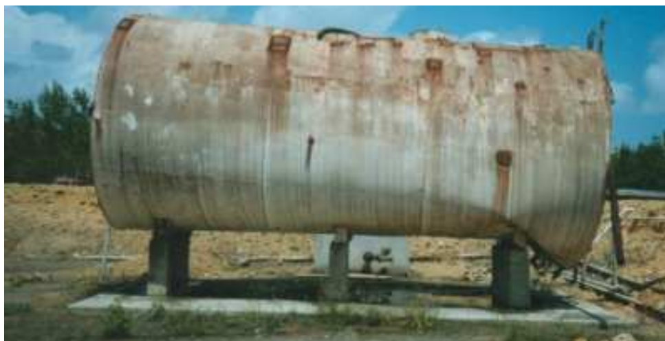
Figura 3: Tanque cilíndrico horizontal con daño.
