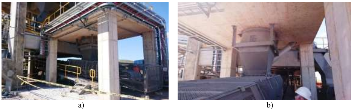
Figura 6: a) Vista general de la estructura durante la etapa de construcción; b) Vista de nivel 177.500 desde abajo
