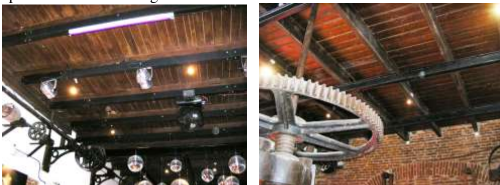
Figura 3: Entrepiso del local bailable 2 y vista de los refuerzos metálicos.
